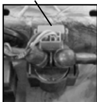
Boîte à fusible
